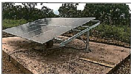
Foto 20. Módulos geradores de energia fotovoltaica
